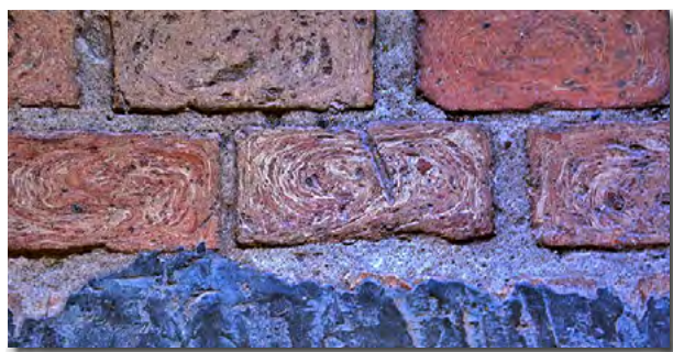
Zamek rawski, wybarwienia cegieł
