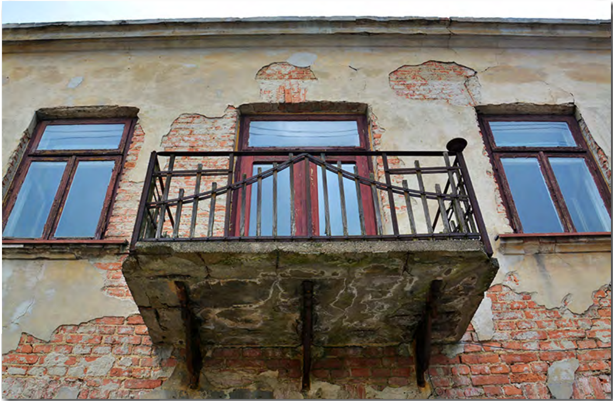
Balustrada balkonu przy ul. Wyszyńskiego 14
