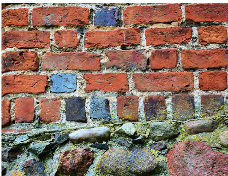
Zamek rawski, wybarwienia cegieł
